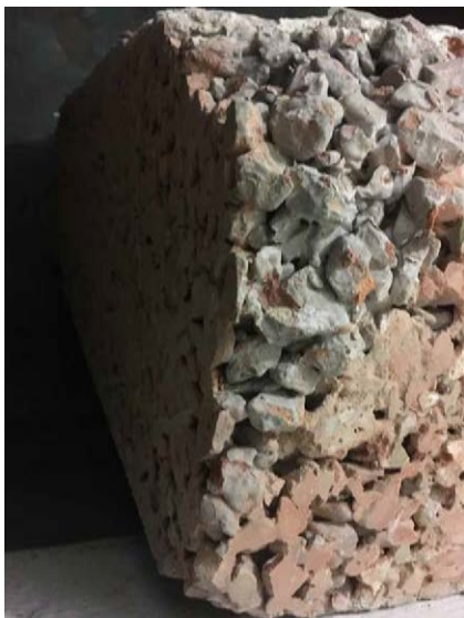
Abb. 5: Teil eines Bohrkerns aus Original-Ziegelsplittbeton. Er wurde bei einer Umbaumaßnahme im Keller entnommen und enthält wesentlich mehr Mauerwerksbruch als heutige R-Betone mit Typ 2-RC-Körnung.
